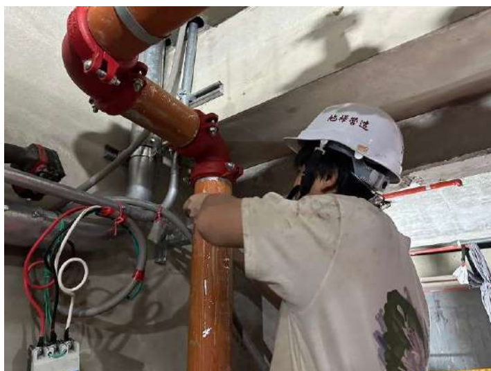
B3F消防配管
