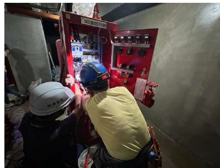
B3F消防設備配線
