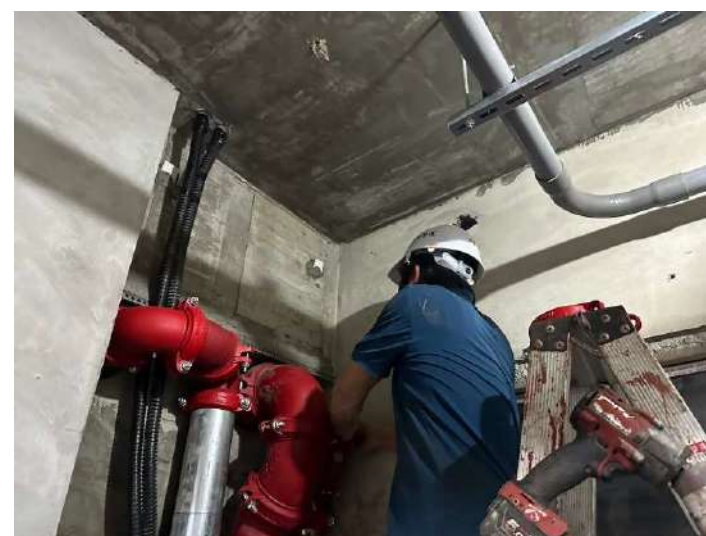
B2F消防配管
