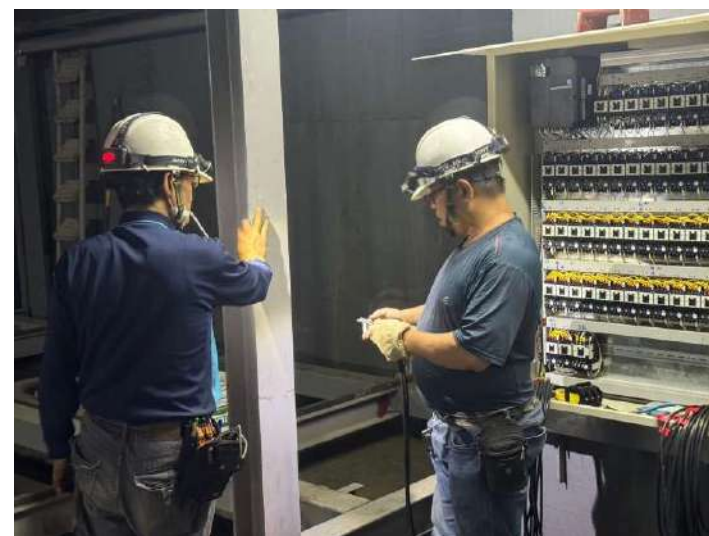
停車設備控制盤電源配線
